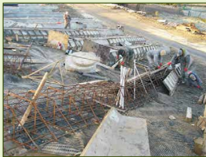
Walka z osuwiskami trwa. Ukończono już budowę umocnień w w Żeleźnikowej Wielkiej.
